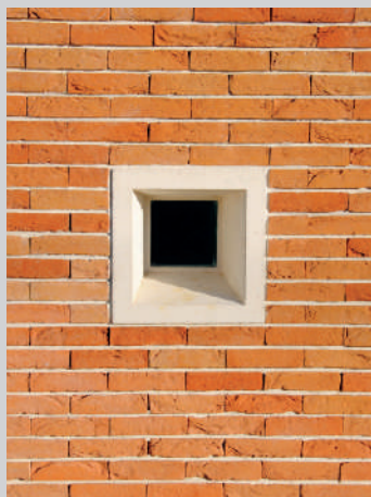
Pavé de verre et calepinage brique
